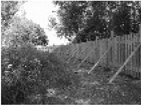
Imagen 8. Empalizada de retención de sólidos transportados por grandes avenidas en los Ojos de Monreal.
